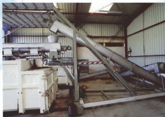
Ensemble de vis de transfert pour évacuation des boues déshydratées Set of screw conveyors to convey dewatered sludges
