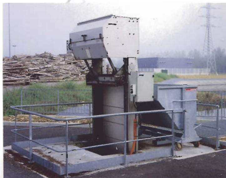
Dégrilleur FJS sur site industriel FJS screener at an industrial site
